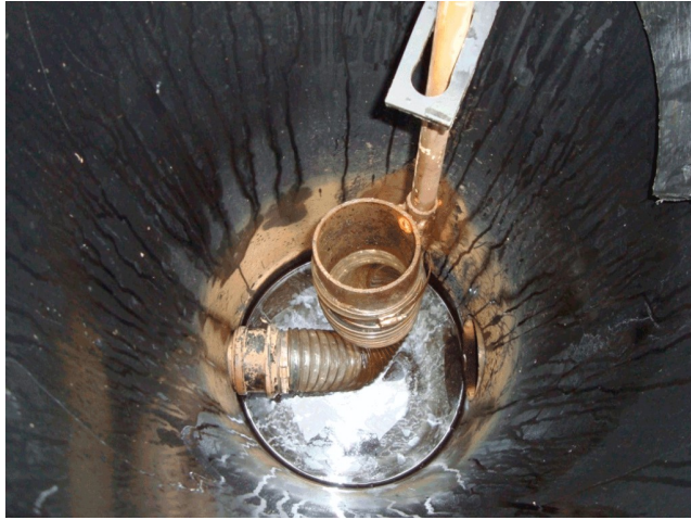
Billede 2. Brønd til regulering af vandstand. Vandstanden i marken vil være den samme som højden på udmundningen af flexslangen. Foto: Kristoffer Piil, Videncentret for landbrug
